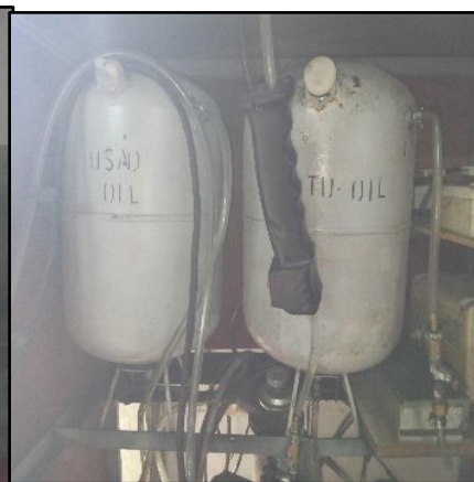
/Figure 4-Compressor tanks)
